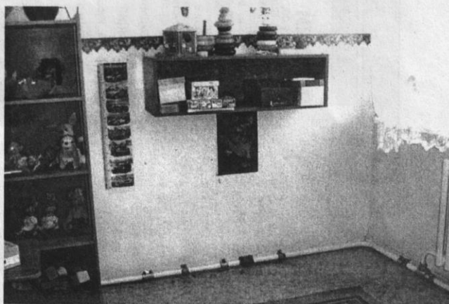
Не счесть хомутов на трубе отопления в детском саду «Умка».
